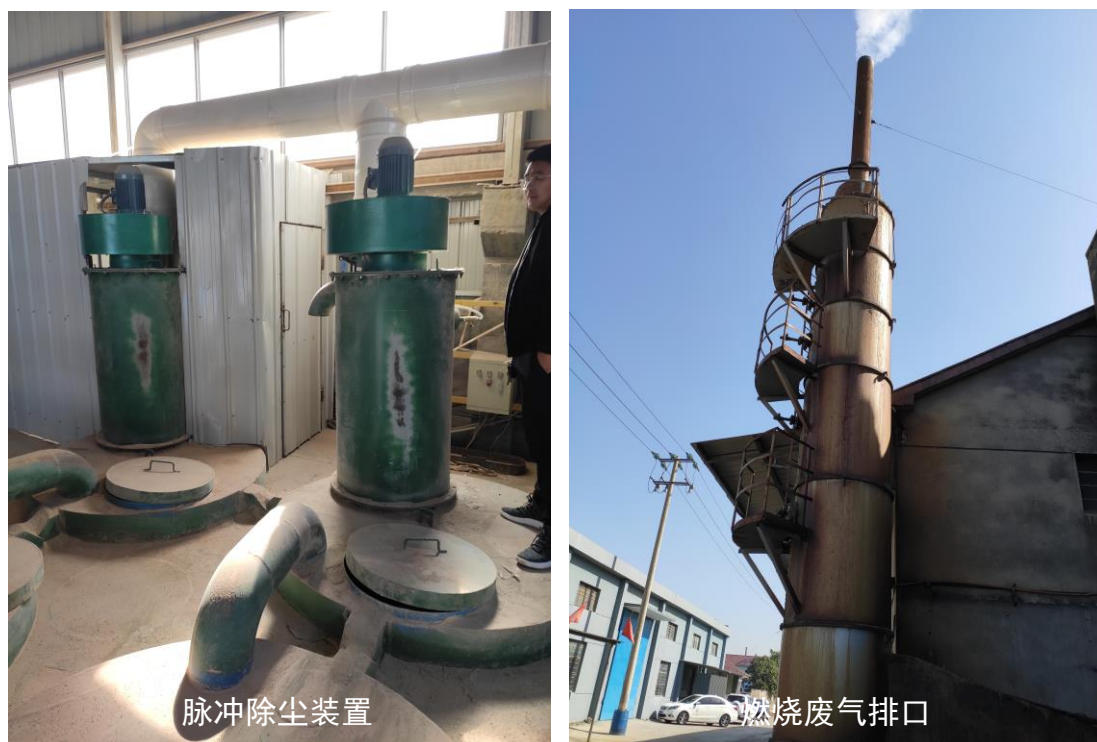
图 4-3 项目废气处理设施
