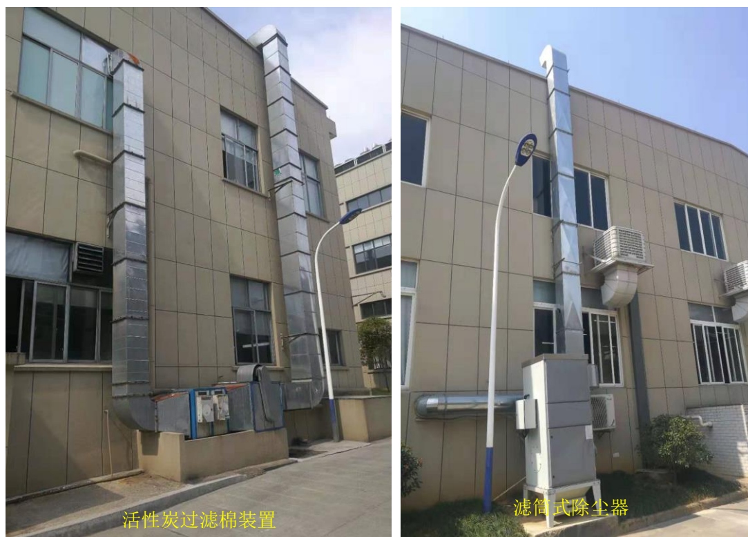
图 4-3 项目废气处理设施
