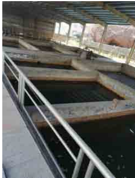
沉淀池，循环水池
