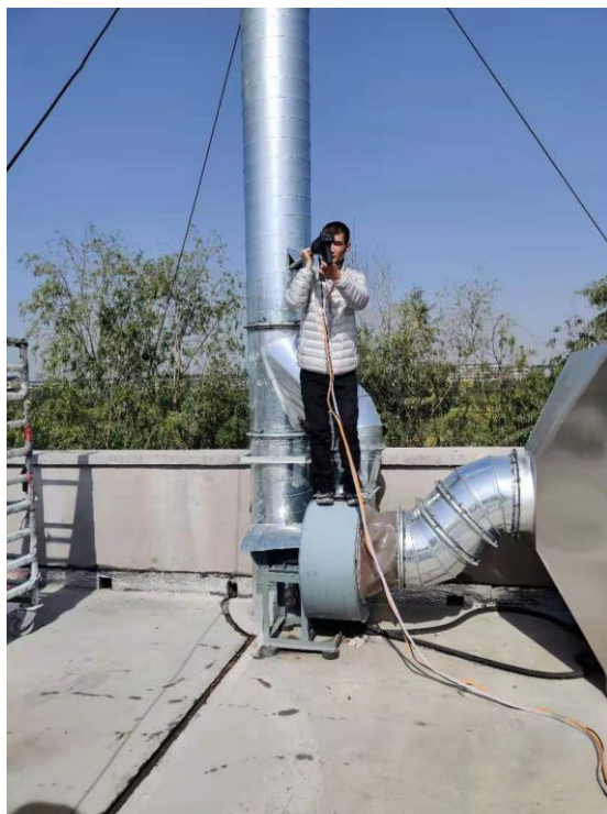
图 4-3 项目废气处理设施
