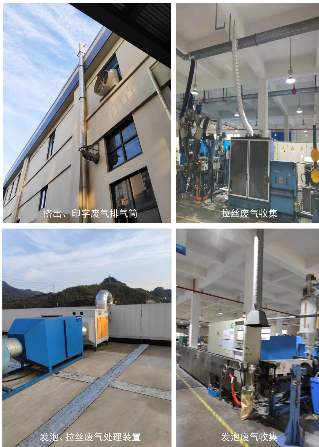
图 4-3 项目废气处理设施
