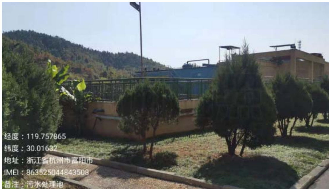
附图 3 污水处理池
