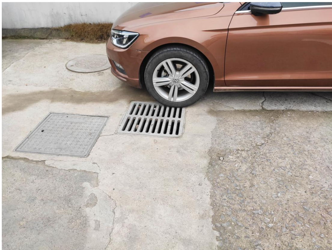
图 4-2 项目污水处理设施
