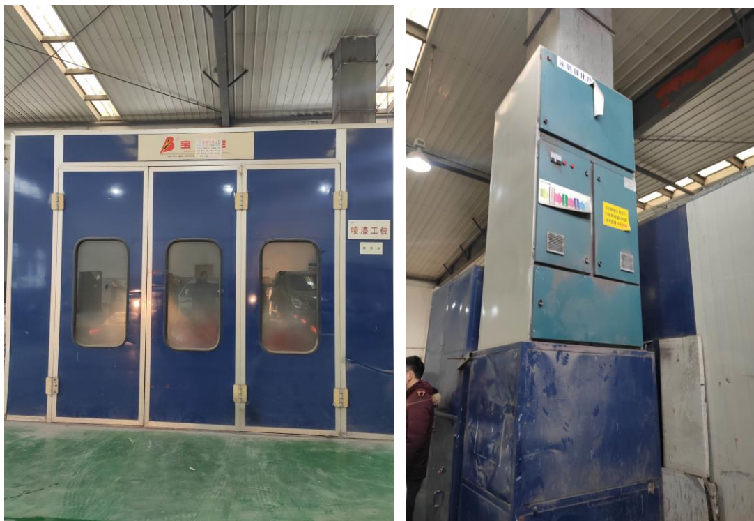
图 4-4 项目废气处理设施
