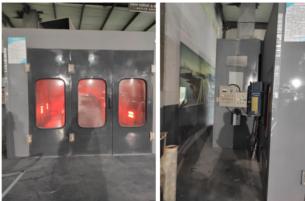
图 4-4 项目废气处理设施
