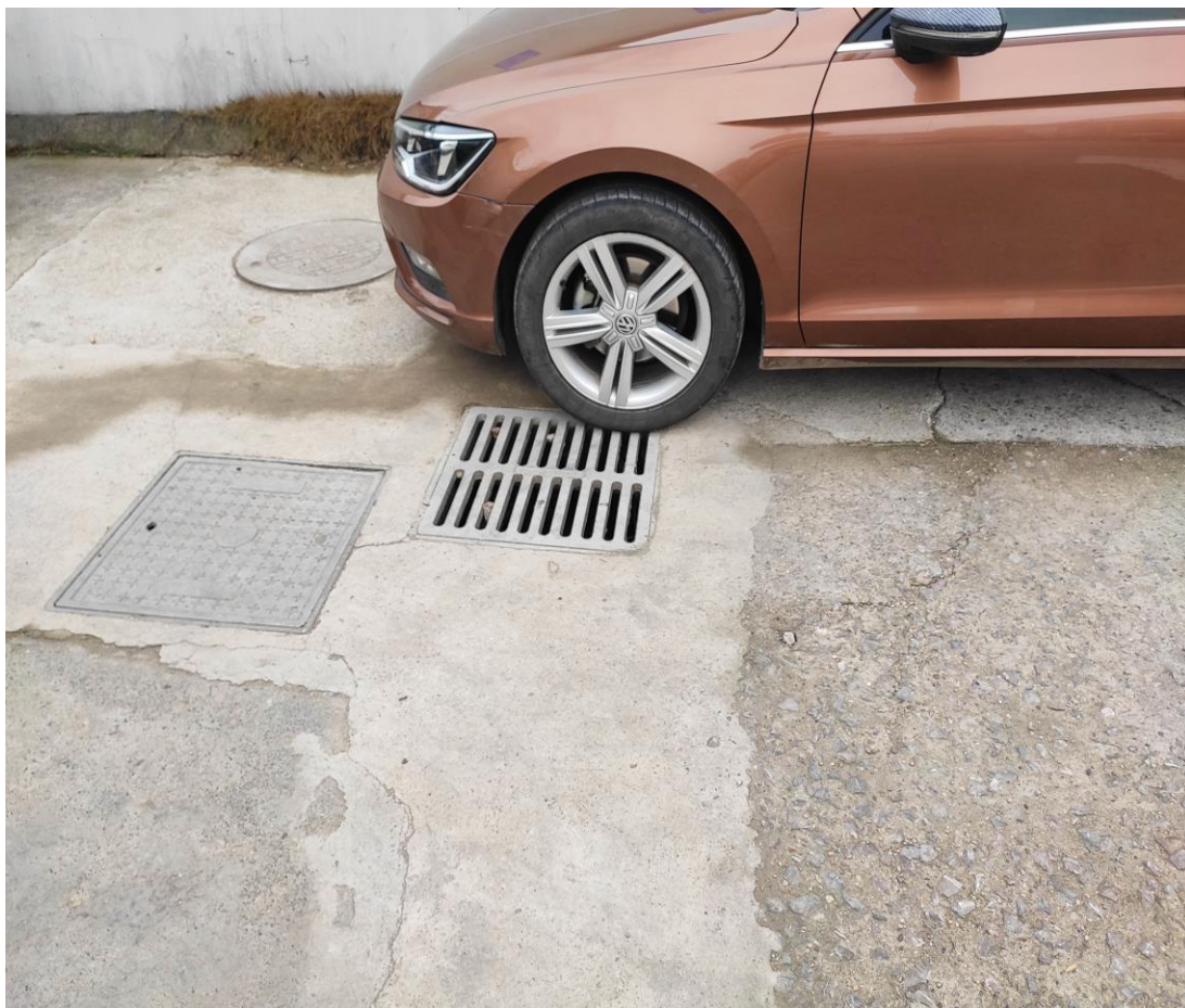
图 4-2 项目污水处理设施
