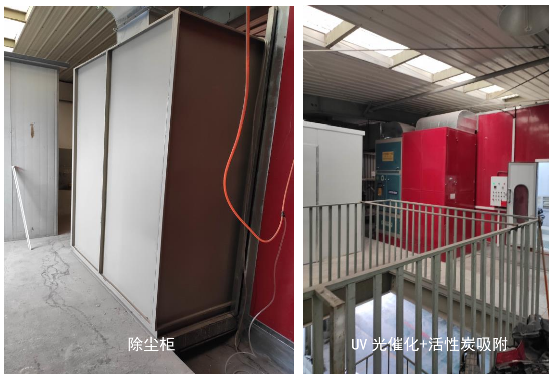
图 4-4 项目废气处理设施
