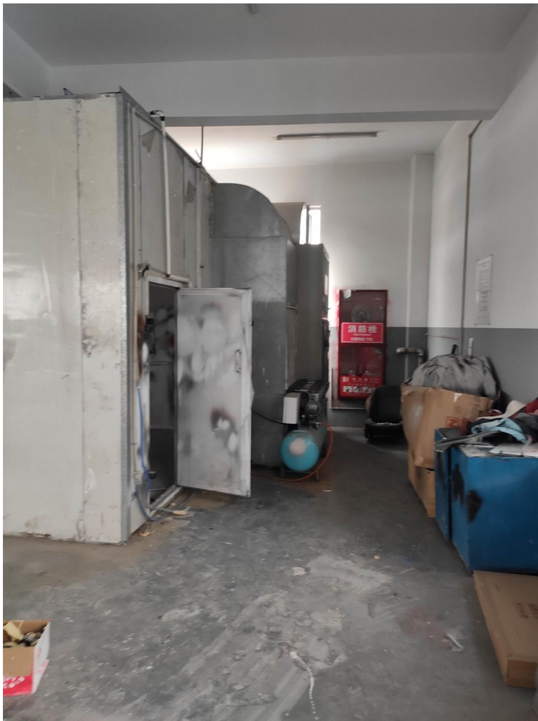
图 4-3 项目废气处理设施
