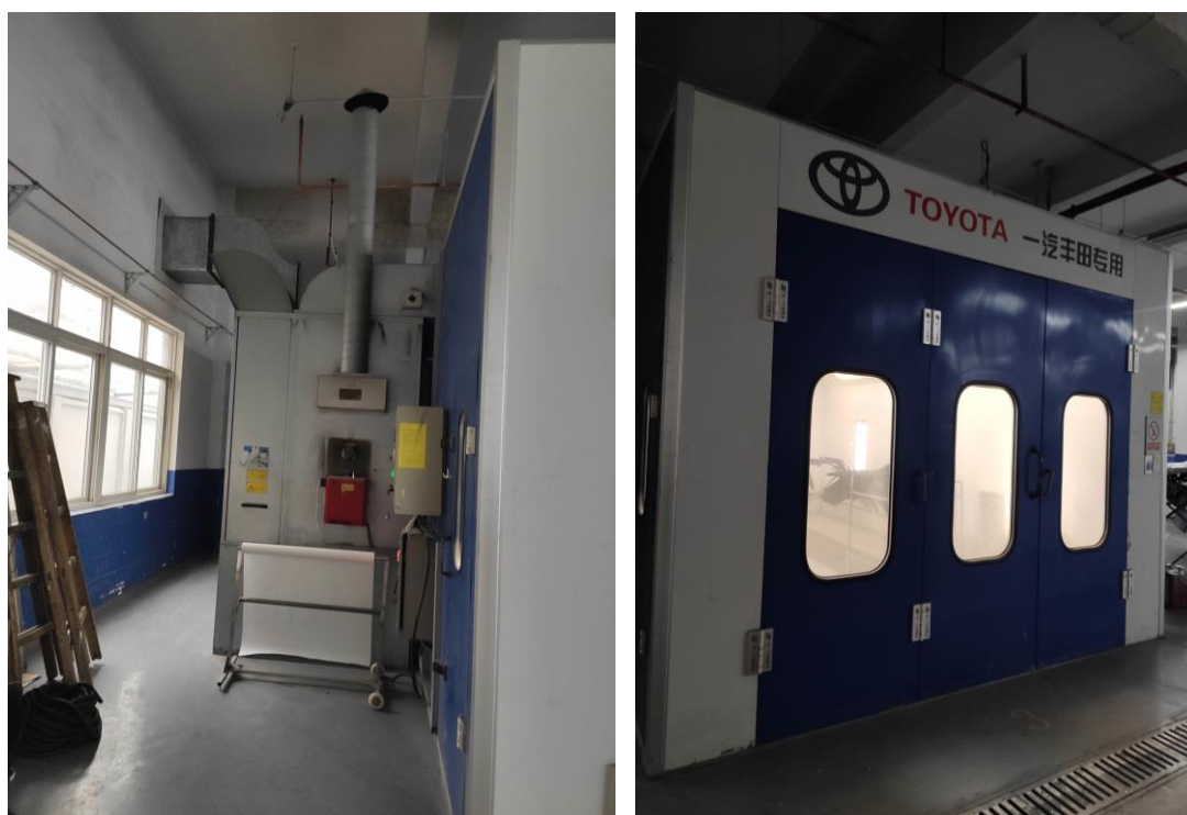
图 4-4 项目废气处理设施
