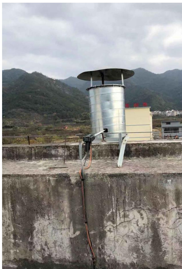
图 4-3 项目废气处理设施
