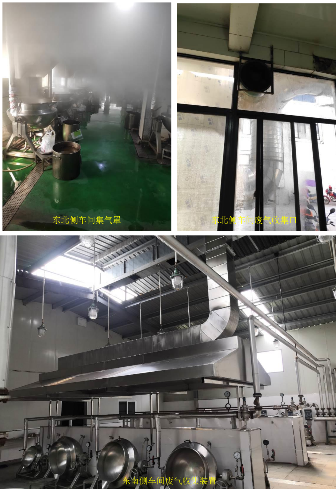
图 4-5 项目废气处理设施
