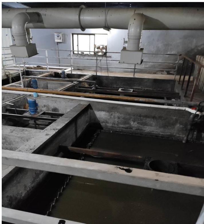
图 4-3 项目污水处理设施
