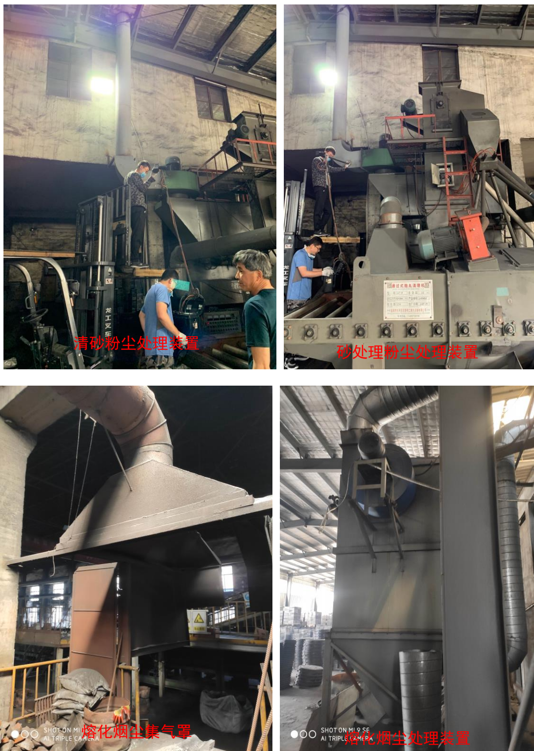
图 4-2 项目废气处理设施
