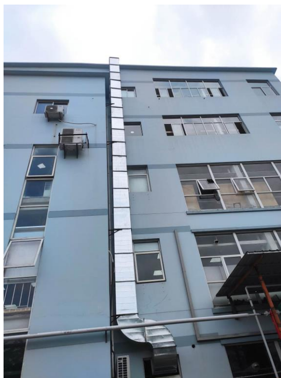
图 4-3 项目废气处理设施
