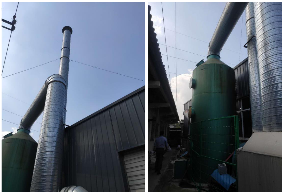
图 4-3 项目废气处理设施图
