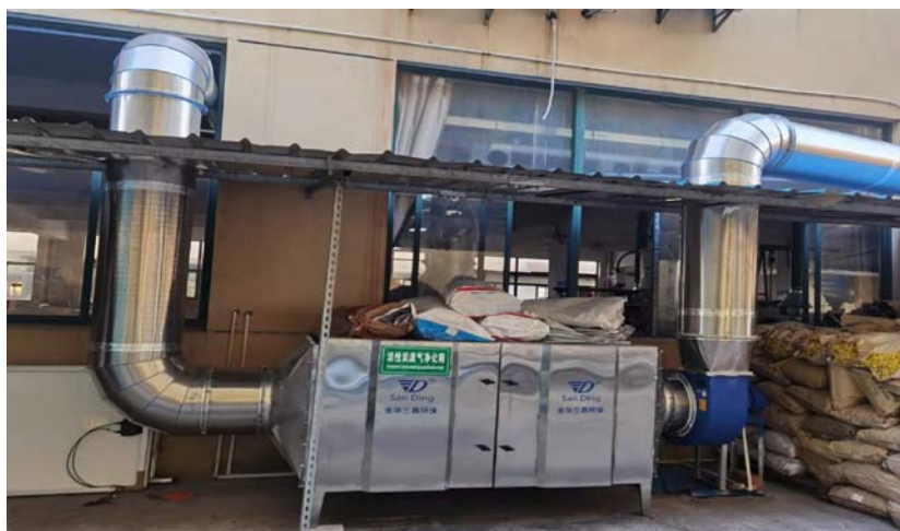
图 4-3 项目废气处理设施
