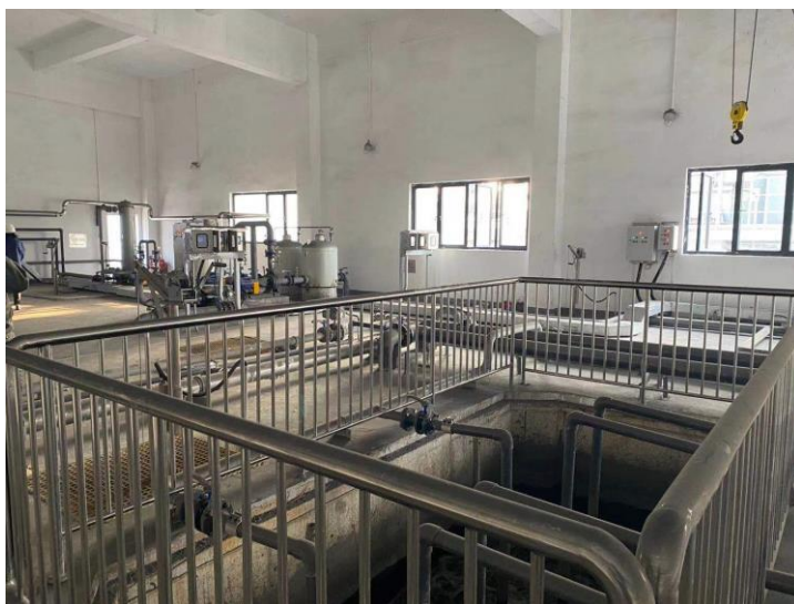
污泥干化废水处理设备
