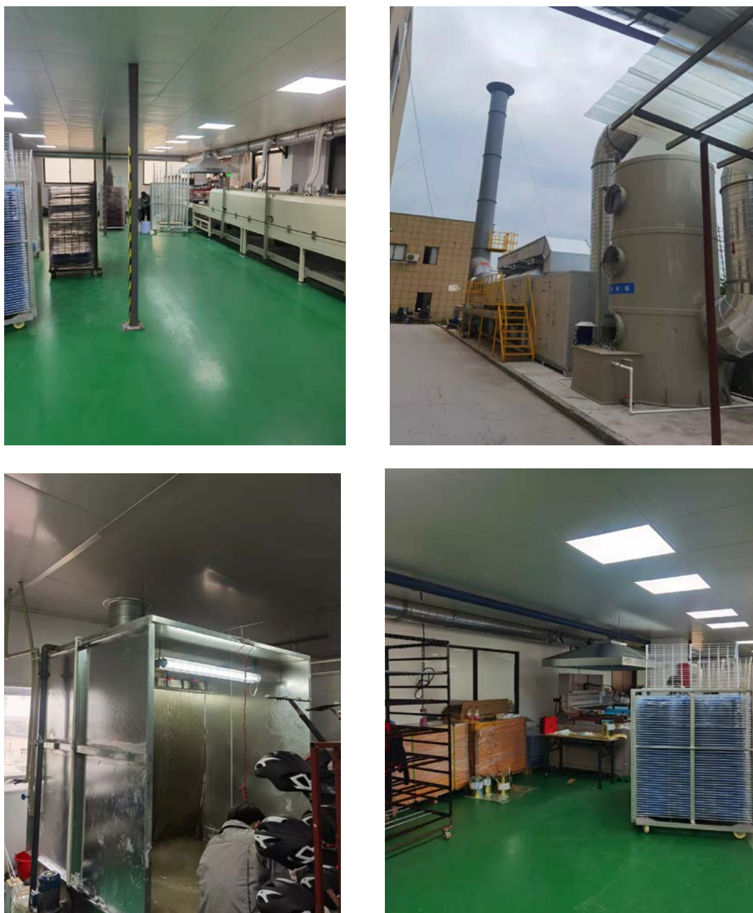
图 4-2 废气收集及处理装置
