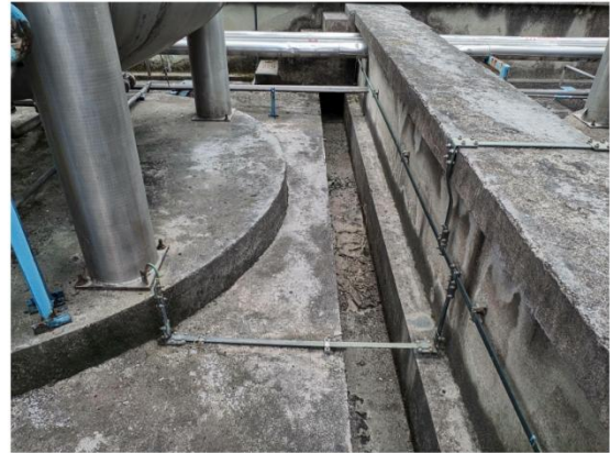
罐区泄露液体收集沟
