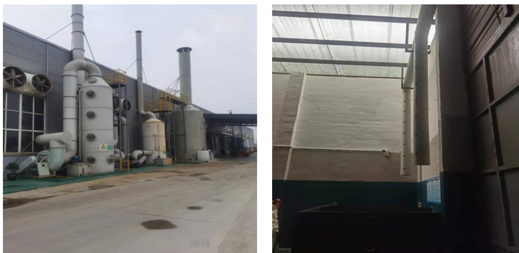
图 4-3 项目废气收集及处理设施
