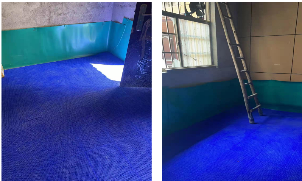
图 4-10 危险废物仓库（此照片为验收会整改基本完成时的照片）
