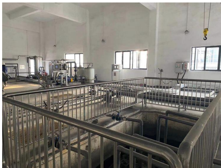
污泥干化废水处理设备
