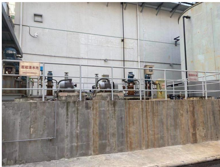
脱硫废水处理设备
