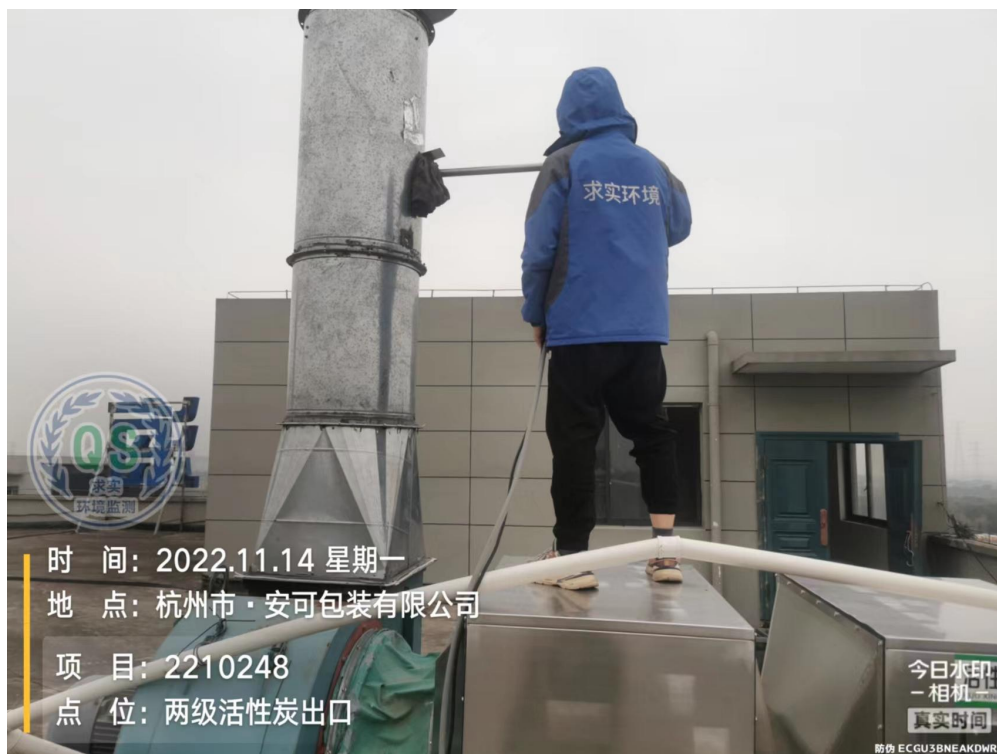
图 4-2 项目废气收集处理设施
