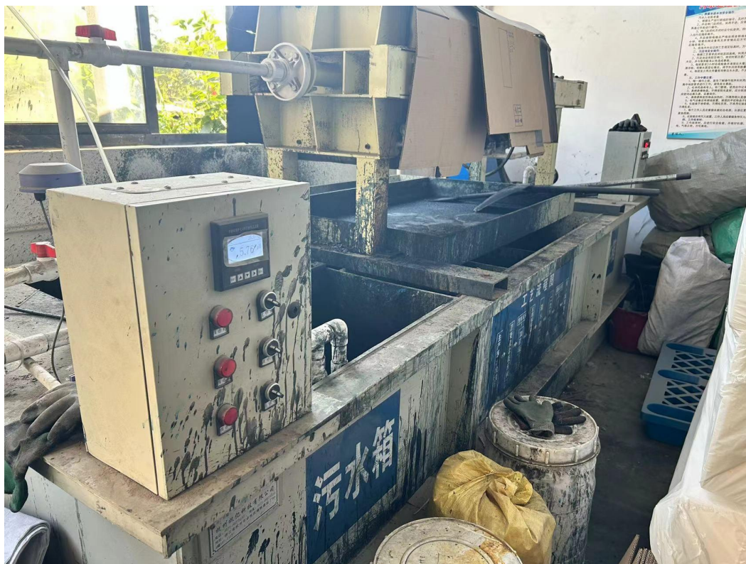
图 4-1 项目废水收集处理设施
