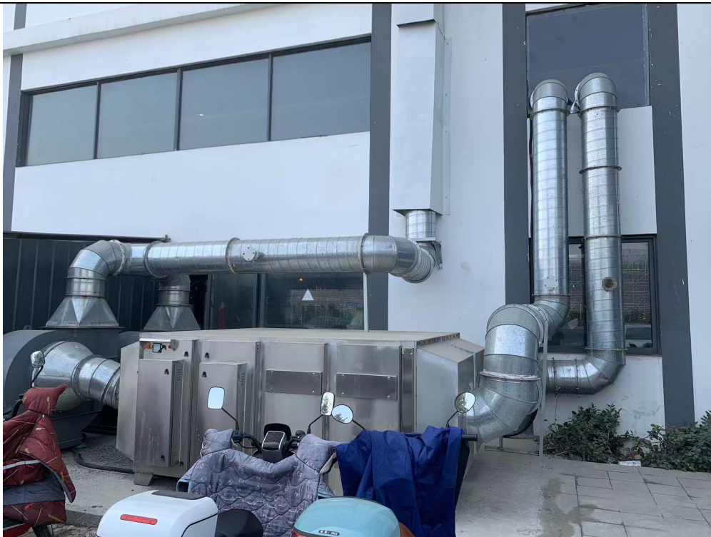
图 4-1 项目废气处理设施
