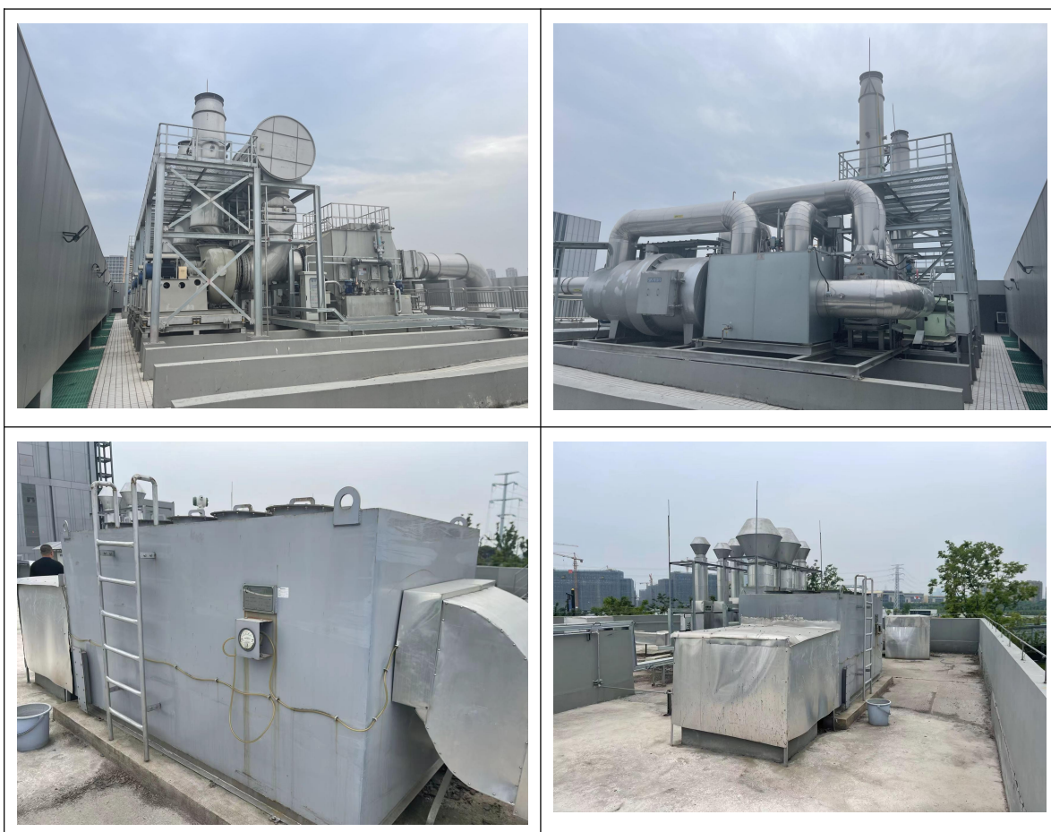
图 4-5 废气处理设施照片
