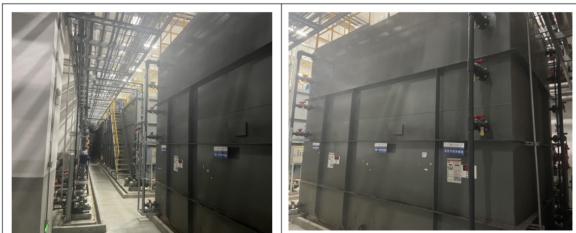
图 4-2 废水处理设施照片
