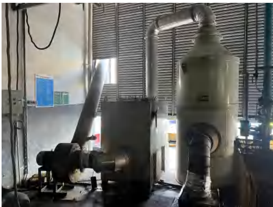
图 4-4 项目有机废气处理装置
