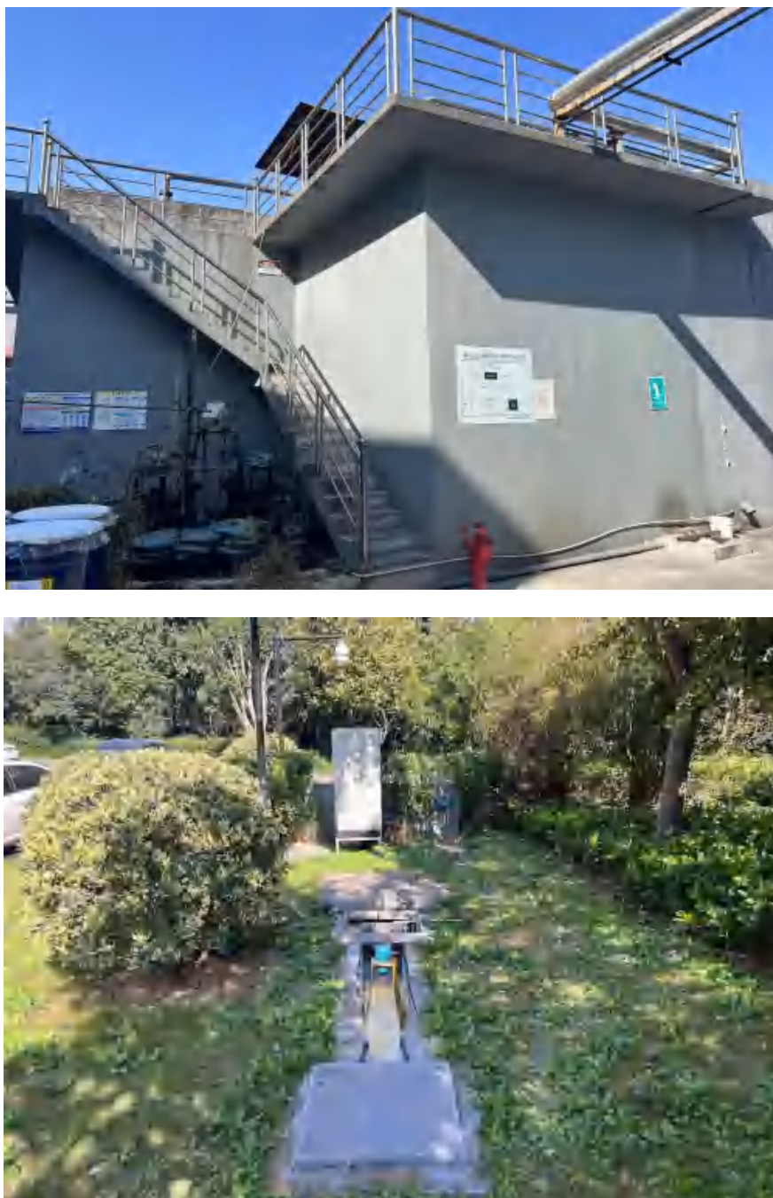
图 4-2 项目废水处理设施及排放口
