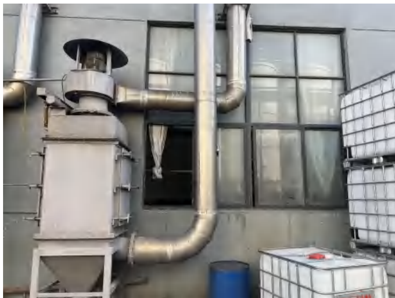
图 4-3 项目除尘装置（上下分别为 2#、6#除尘装置）
