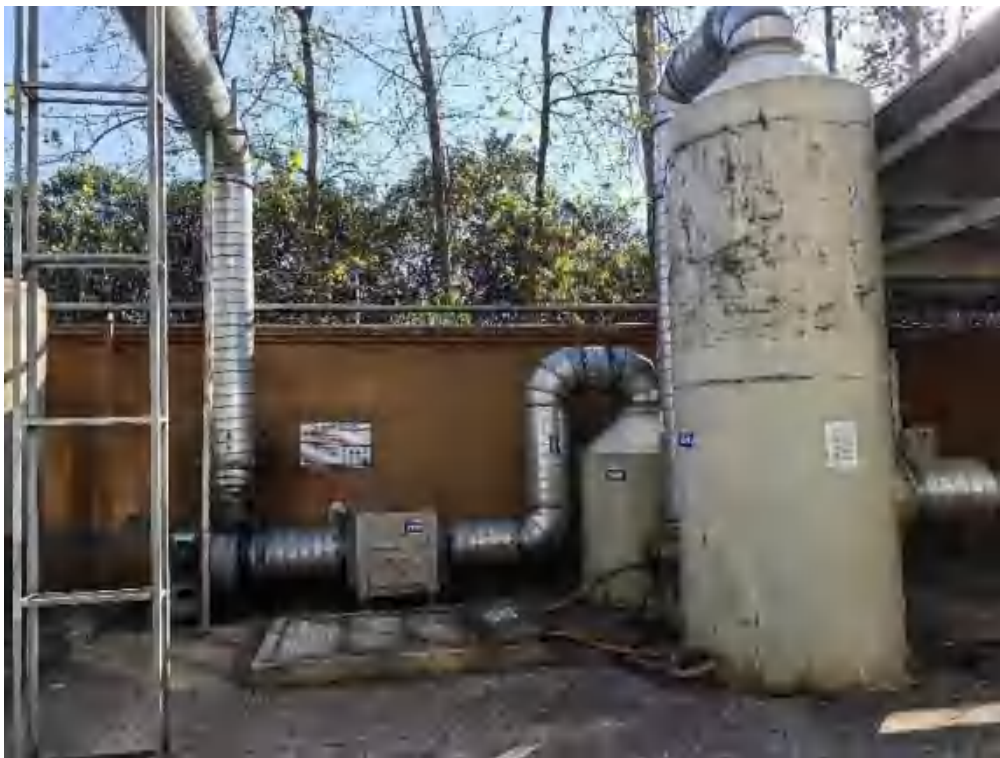
图 4-4 项目废气处理设施
