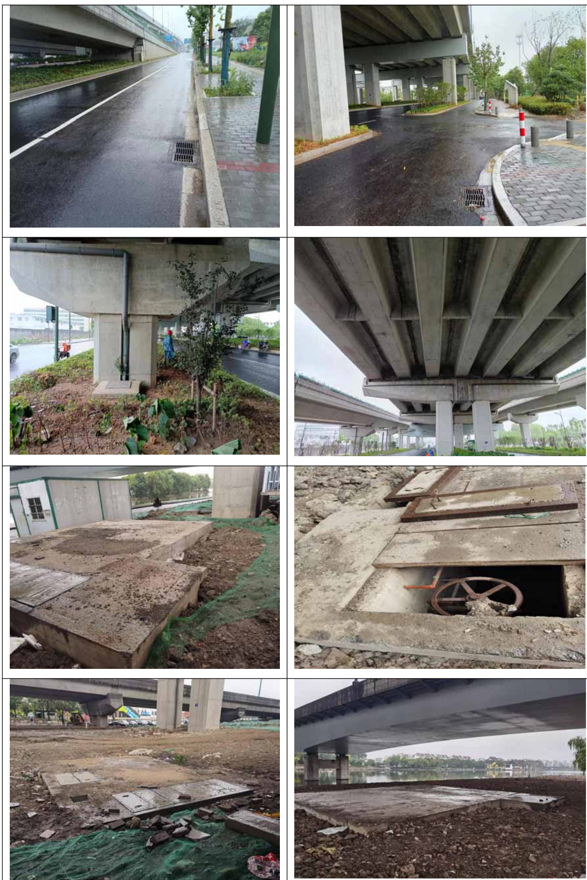
图 8.2-1 雨水地面收集系统及雨水收集应急池
