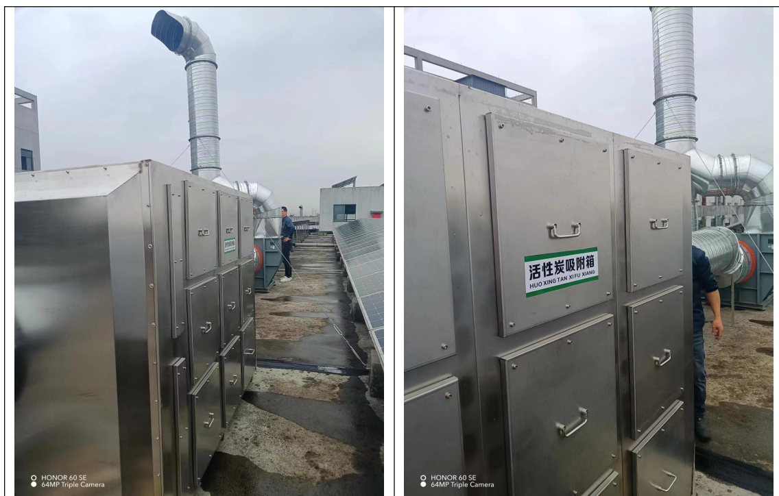
图 4-3 废气处理设施照片
