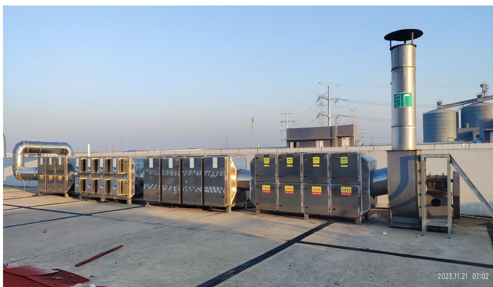
图 4-4 项目密炼、挤出、硫化、冷却废气处理设施
