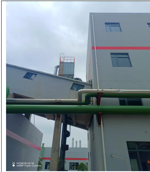
碎煤粉尘处理设施
