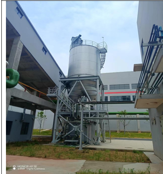
石灰石粉仓及处理设施
