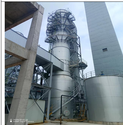
锅炉脱硫处理设施
