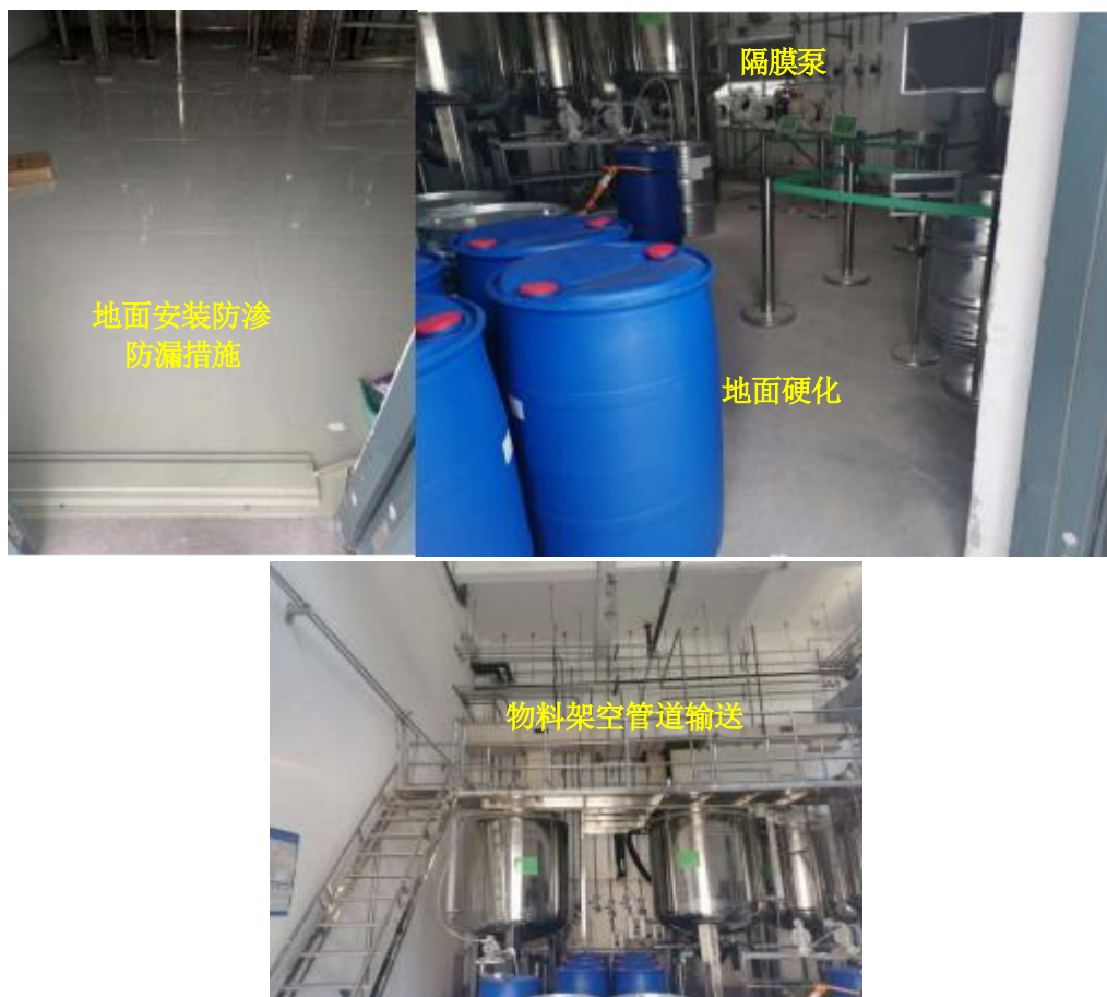
图 5.1-1 投料间及输送管道现场图片
