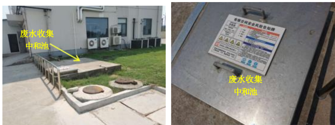
图 5.1-10 废水收集中和池照片
